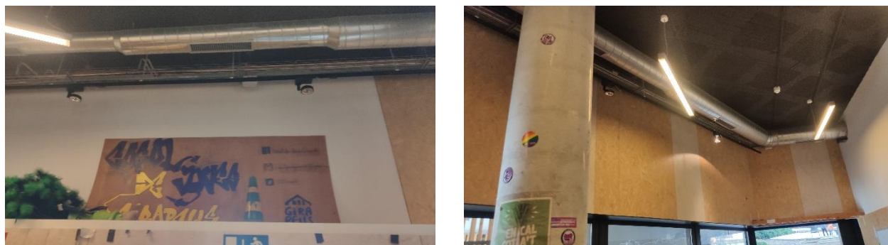
Fig. 7 Vista dreta recorregut patinet d'instal·lacions – sala tècnica
