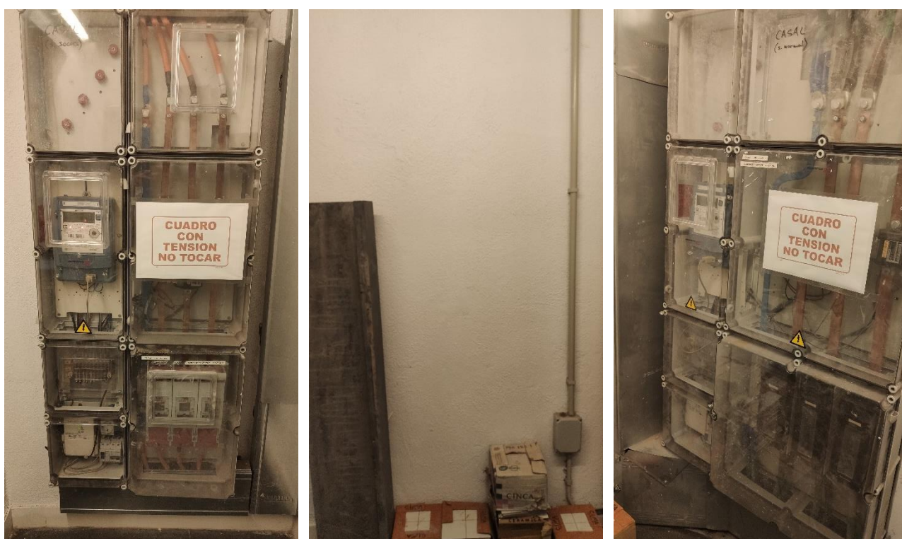
Fig. 8 Vista general sala tècnica
